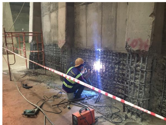
Xử lý cốt thép bị ăn mòn
