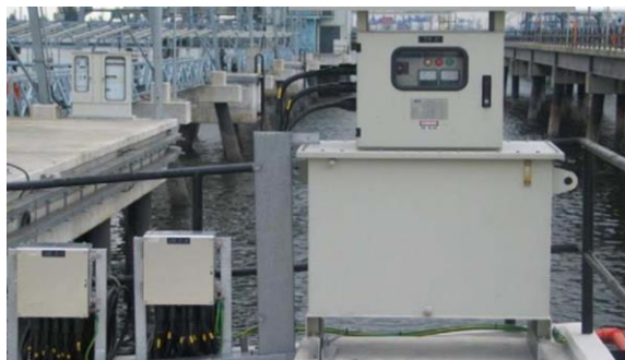
Transformer Rectifier và hộp phân phối tại cầu cảng
