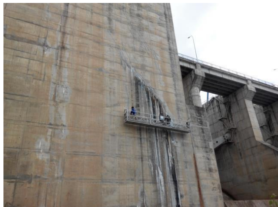
Nứt tại đập thủy điện
