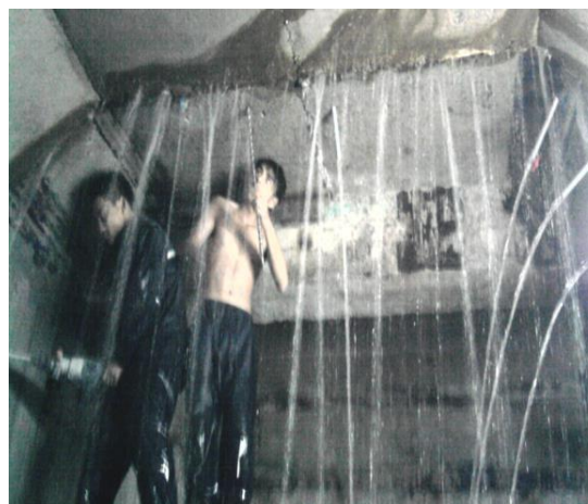
Rò rỉ tại hành lang đập
