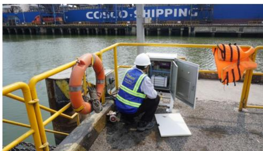
Tủ điều khiển
