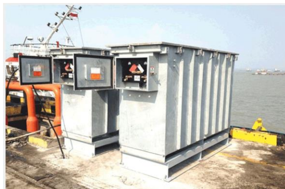
Transformer Rectifier dạng tủ ngoài trời
