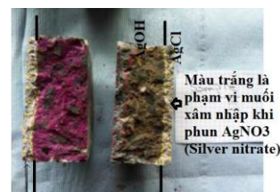
Màu trắng là phạm vi bị carbonat - độ pH trong bê tông giảm, khi dùng Phenolphthalein 1%
