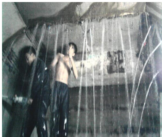
Rò rỉ nước tại hành lang đập thủy điện
