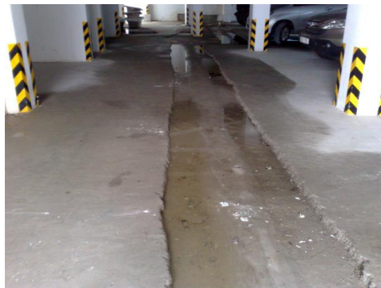
Rò rỉ tại khe co giãn tầng hầm
