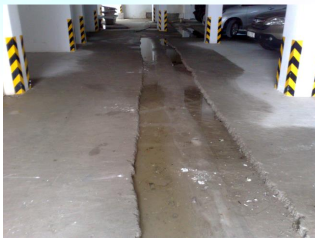
RÒ RỈ KHE CO GIÃN TẦNG HẦM
