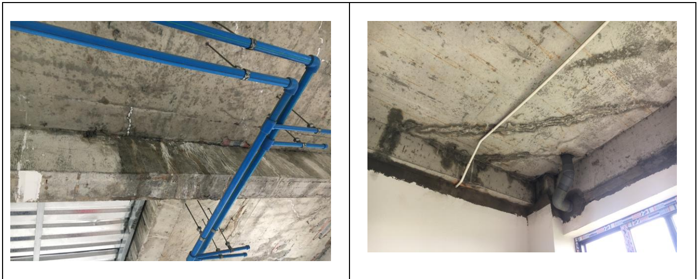
Hình 1 : Sàl mái bị thấm dột
