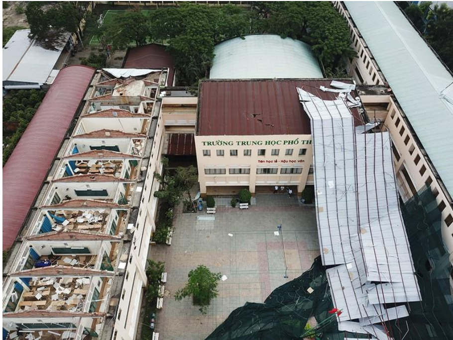
Hình 1 : Mái tôn bị lốc xoáy
