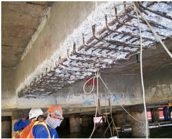
Hình 3: Đang đục phần kết cấu bị ăn mòn
