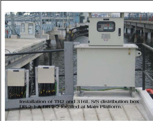
Hình 4 : Biến áp đặt trên mặt cảng
