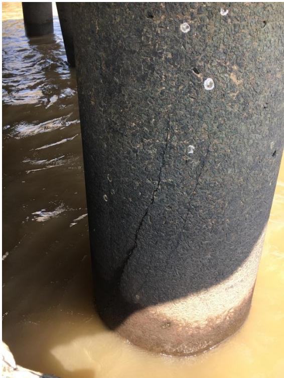
Hình 1- cọc UST bị nứt
