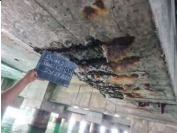
Hình 1 : thi công kém , không có lớp BTBV
