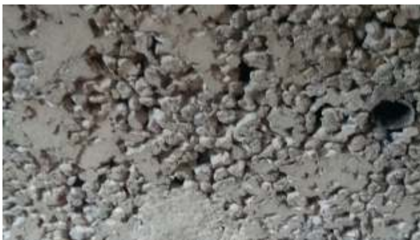
Hình 3 : khuyết tật rỗ bê tông
