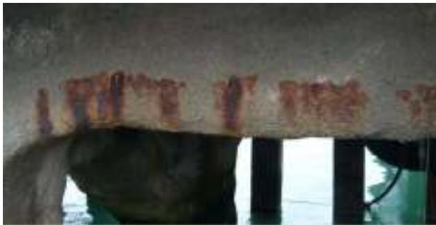
Hình 11 : Kết cấu bị ăn mòn
