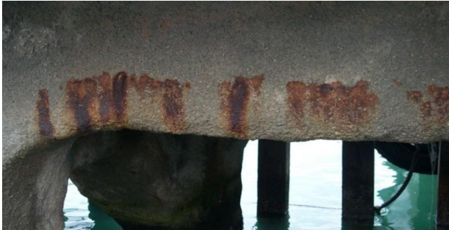
Hình 11: Kết cấu bị ăn mòn
