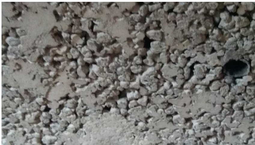
Hình 3: khuyết tật rỗ bê tông
