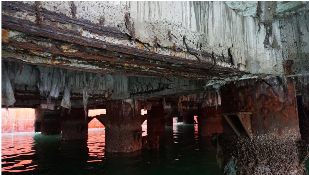
Hình 7 : Hiện trạng ăn mòn cầu cảng
