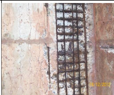
Hình 3: Ăn mòn tại nhà máy phân bón
